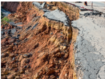
• un glissement de terrain
