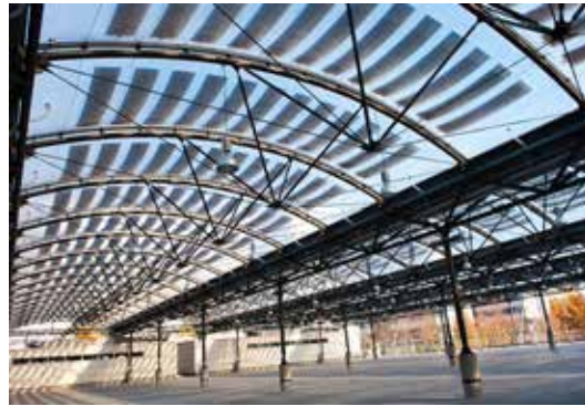
Fig.64: Carport Roof at the 'Abfallwirtschaftsamt' Credit: © Taiyo Europe GmbH
