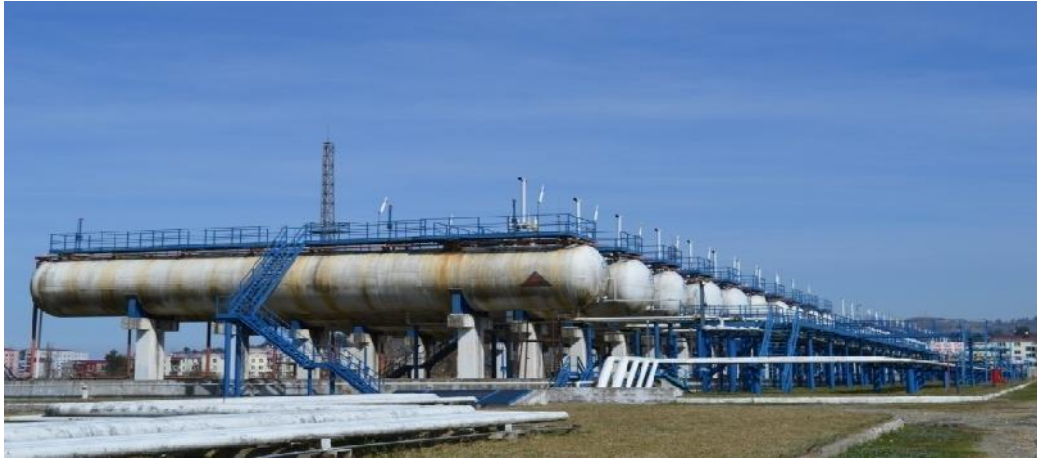
ნახ.5.7. ბათუმის გაზის ტერმინალის სარეზერვუარო პარკი . ჰორიზონტალური ტიპის რეზერვუარები, პროპან-ბუთანის აირის შენახვისათვის. 200 მ 3 ტევადობის
